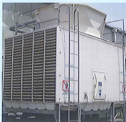
冷却塔姿写真
